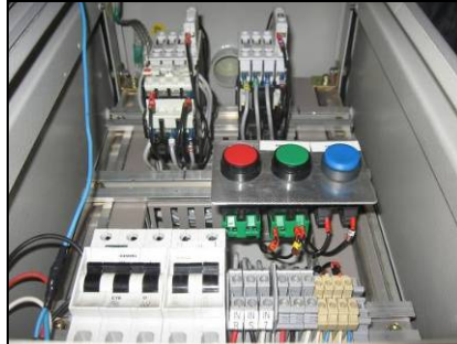
Figura 8 – Caixa de comando elétrico da chave
