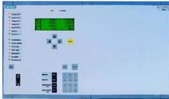
Figura 5 – Relé Numérico de Proteção de Distância 7SA612
