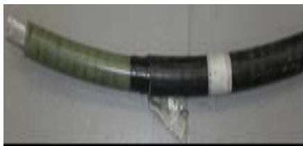
Figura 7. Cabo degradado preparado para o ensaio elétrico.
