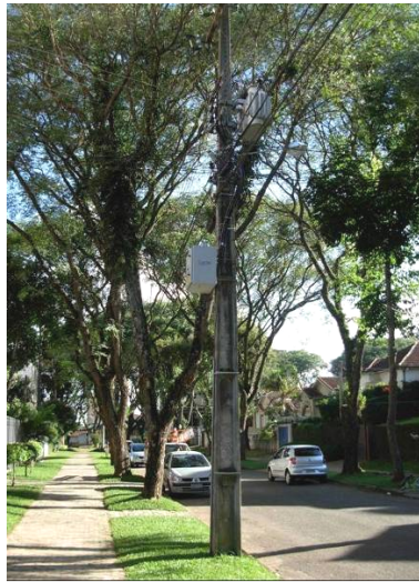
Figura 10 – Vista Geral da Rede de Distribuição com a Central Remota
