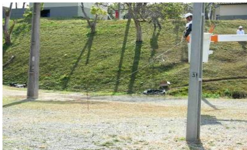
Figura 6 – Simulação em Campo de Falta de Alta Impedância
