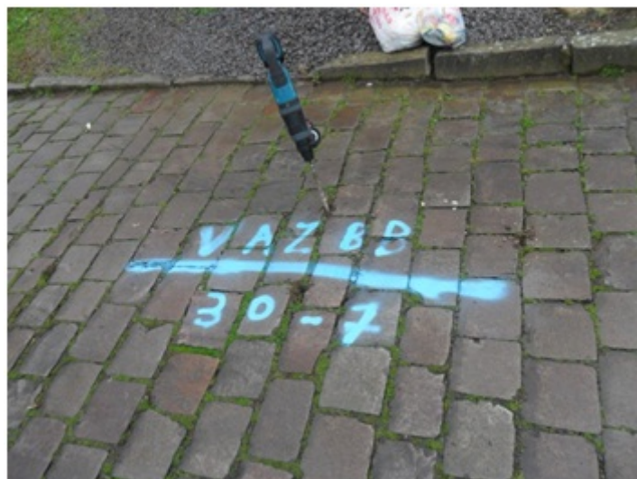
Figura 5 - Pesquisa de vazamentos.
