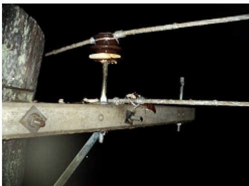
Figura 8 – Ocorrência na rede rural com descarga direta em cruzeta CL
