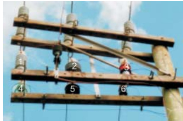
FIGURA 6. Distribuição e ordenação dos isoladores de prova instalados no poste. Isoladores: (1) Pilar; (2) Polimérico de alta densidade para 34,5 kV; (3) Polimérico anti-poliuição; (4) Vidro RT15; (5) Cerâmico anti-poliuição; (6) Hitop.
