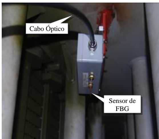
Figura 16. Sensor óptico instalado no gerador.
