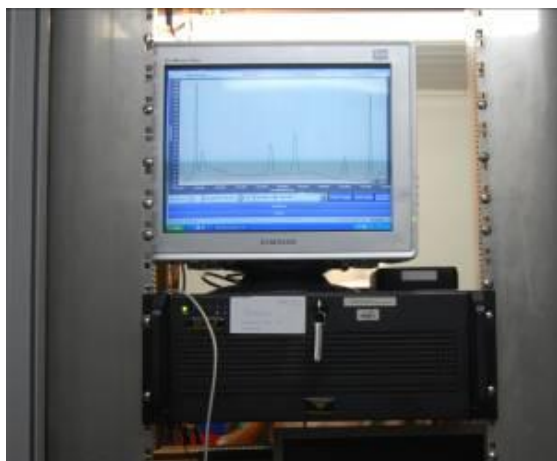
Figura 15. Sistema de monitoramento remoto instalado no rack do QLC da Máquina 3.
