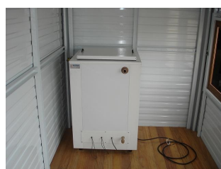
Figura 16. Reservatório de água instalado no interior do trailer
