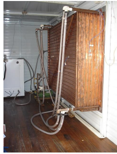
Figura 22. Vista geral das conexões hidráulicas
