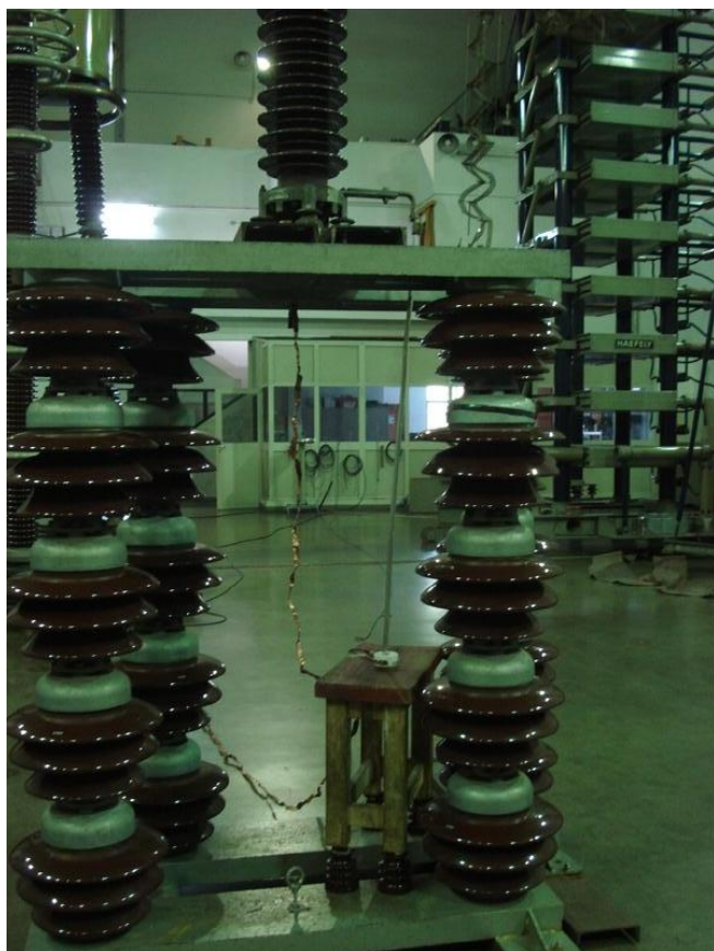
Figura 17 – TC de alta frequência instalado no condutor de aterramento do pára-raios da fase AZ LTA GUA-NOD.
