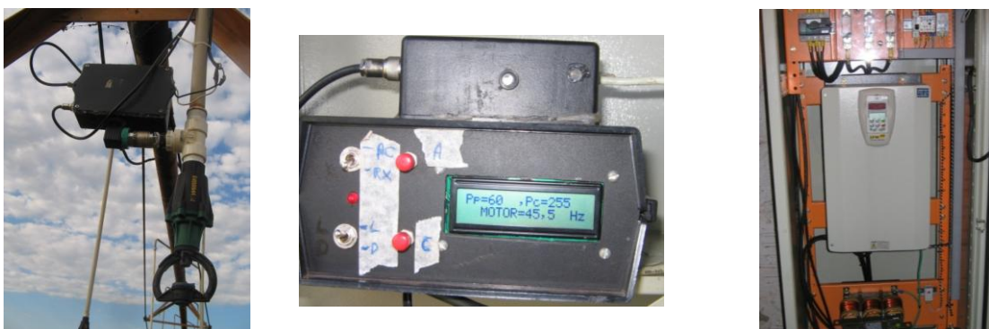
Figura 5: Unidade de aquisição de dados, unidade de controle e inversor de frequência
