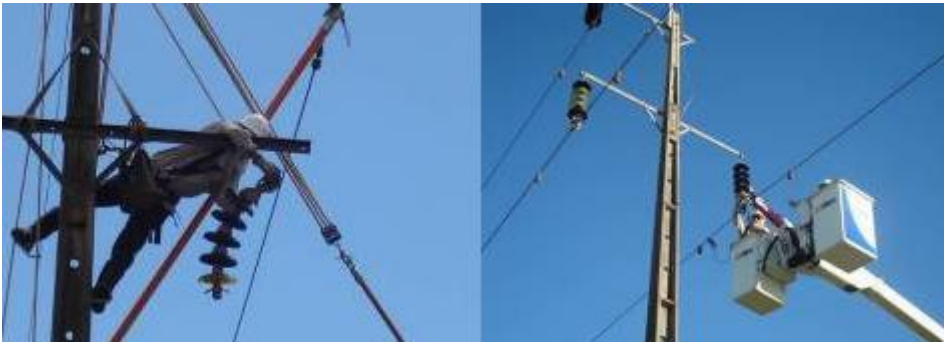
Foto 2 – Eletricista substituindo isolador (linha viva á distância e substituição de isoladores com a cesta aérea..
