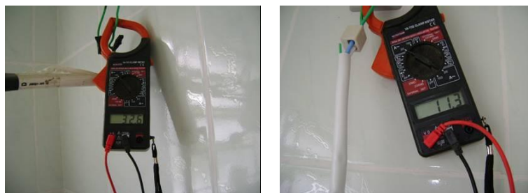
Figura 5. Medição de corrente do chuveiro elétrico
