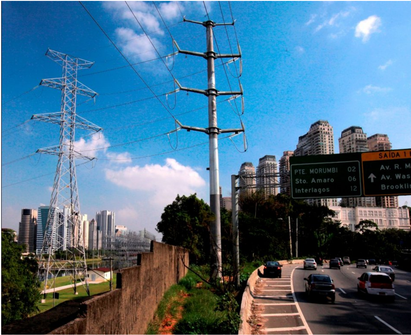
Fig. 2 - Torre Monotubular em Linha de 138 kV instalada em espaço estreito ao lado da Avenida Marginal Tietê, em São Paulo
