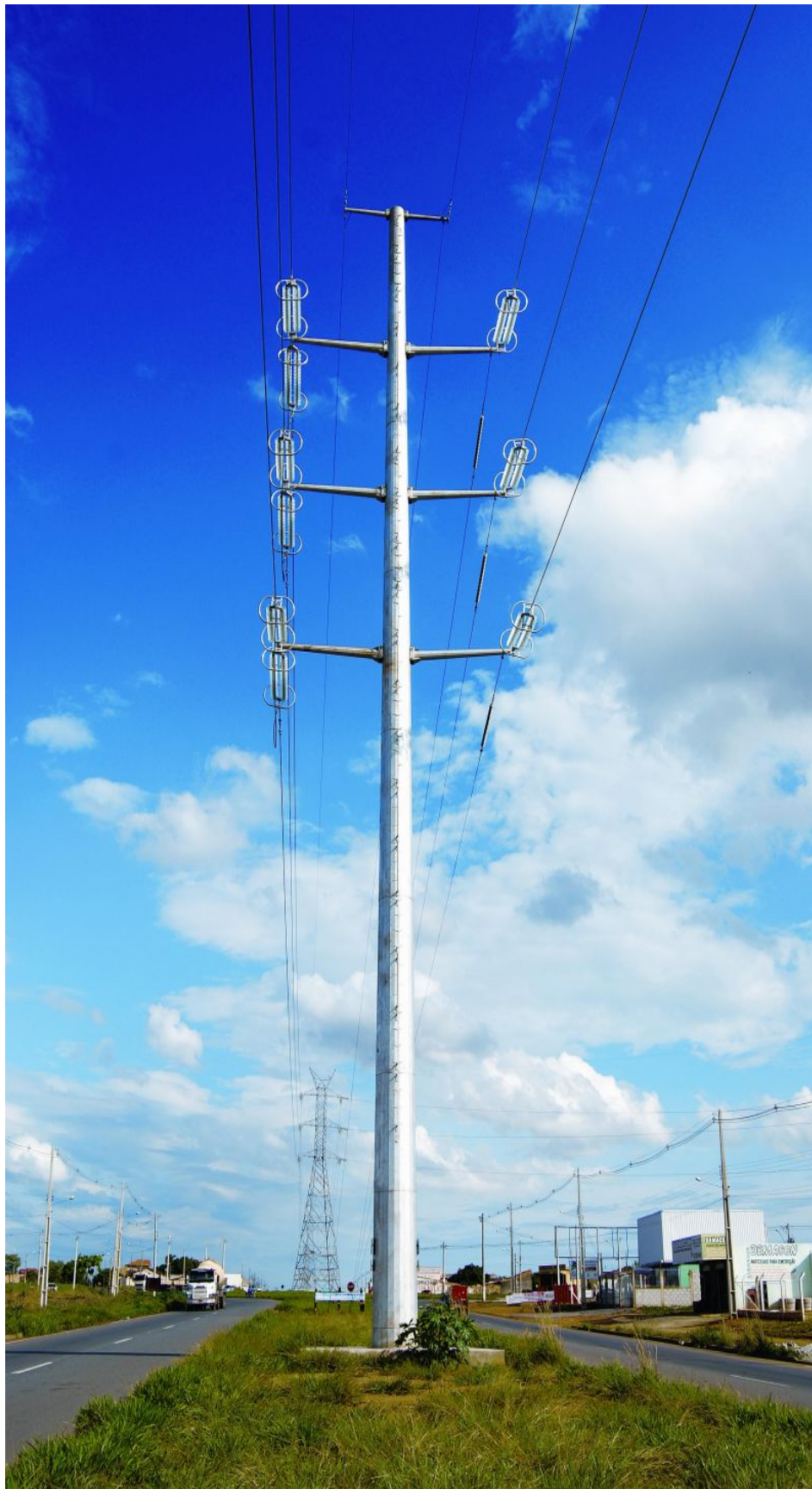
Fig. 3- Torre Monotubular em Linha de 230 kV instalada em canteiro central de Avenida - Goiânia - GO
