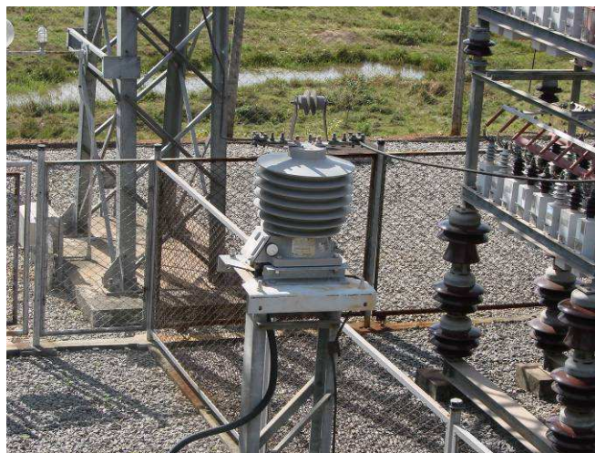
Foto 3 – TC de 34,5kV com isolamento em EPOXI.
