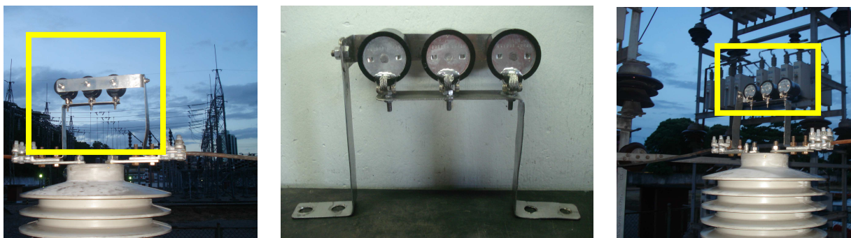
Foto 7 – Para-raios ZnO 440V/20kA, em paralelo, instalados nos primários dos TCs de neutro.
