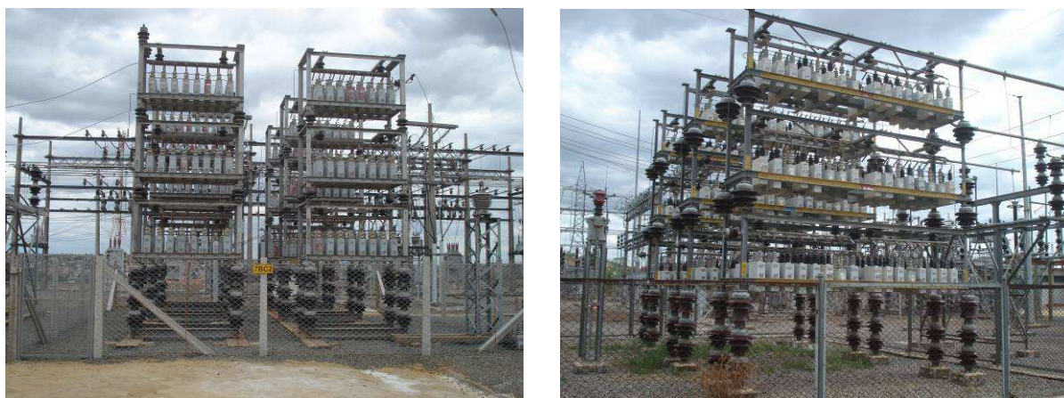
Foto 1 – Bancos de capacitores 138kV em subestações.
