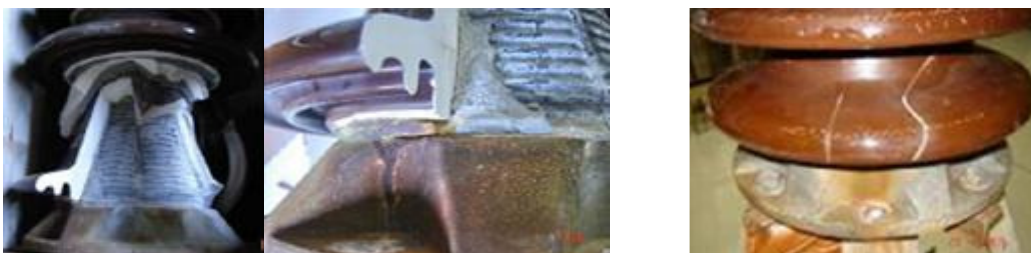
Figura A.2 – Seção inferior da coluna A1 com primeira saia quebrada e trincas na seção da coluna B1.
