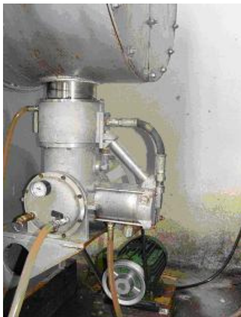
Figura 3 – Motor Viebach ST 05G instalado.
