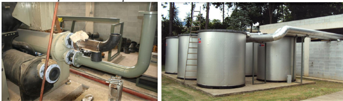
Foto 5 – Instalação Chillers e Tanques
