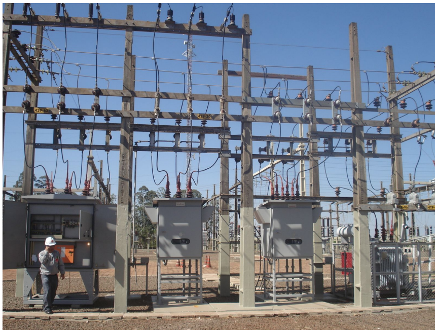
Figura 06: Disjuntores antigos - Subestação São Gabriel D'Oeste.
