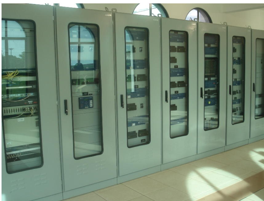
Figura 08: Plataforma de Supervisão e Controle SEL
