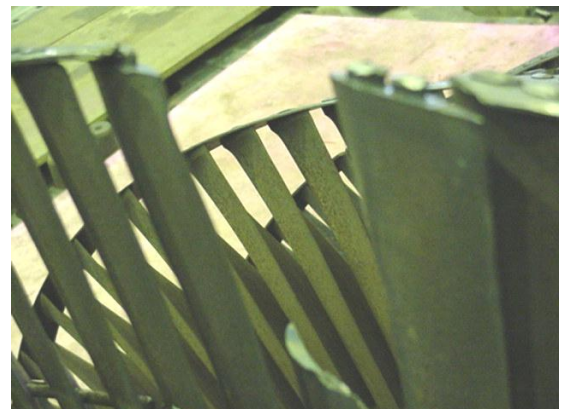
Figura 3. Vista da palheta fraturada.
