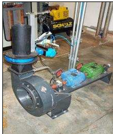
FIGURA 10 – Bancada de Ventiladores / UFMT
