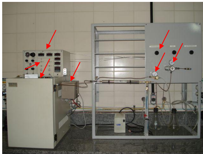
Figura 5 – Problemas no cromatógrafo: vazamentos e queima de componentes elétricos e eletrônicos.
