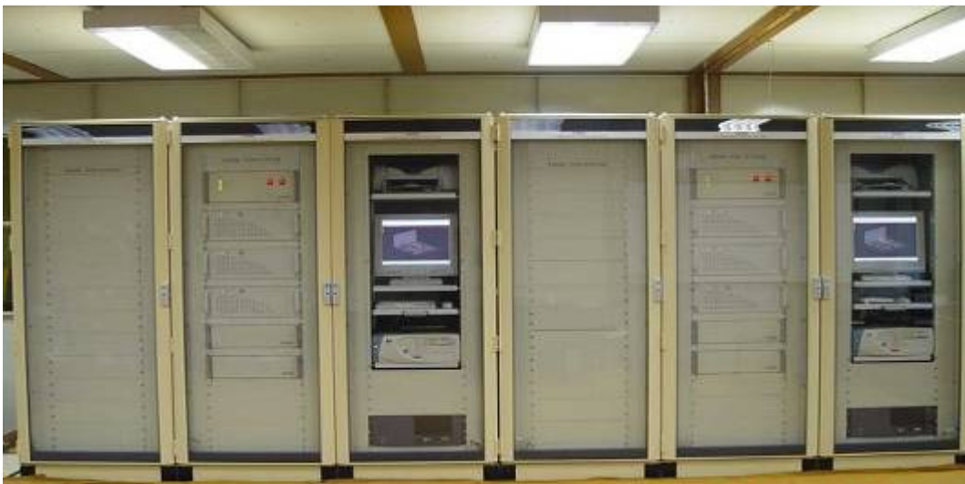
FIGURA 6 – Unidades de comunicação, processamento e IHM dos sistemas de 50Hz e 60Hz
