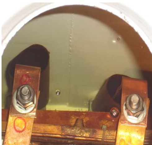
FIGURA 4 - DETALHE INTERNO DAS CONEXÕES ENTRE OS TERMINAIS DO ENROLAMENTO DE BAIXA TENSÃO
