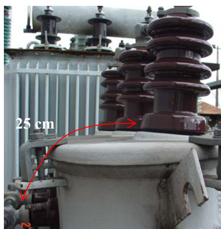
FIGURA 2 - DISTÂNCIA ENTRE AS BUCHAS DE ALTA E BAIXA TENSÃO INFERIOR À DISTÂNCIA MÍNIMA DE SEGURANÇA
