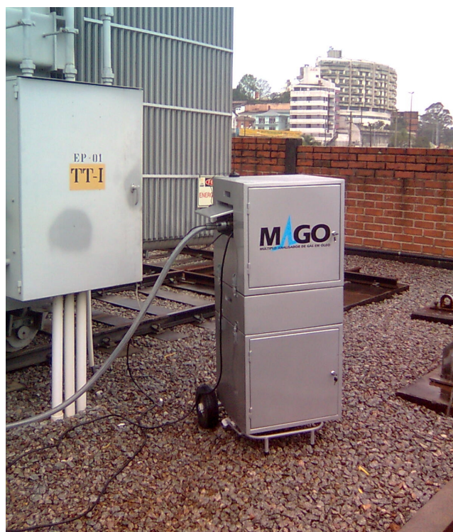
Figura 4. MAGO II em operação na subestação de Coqueiros.
