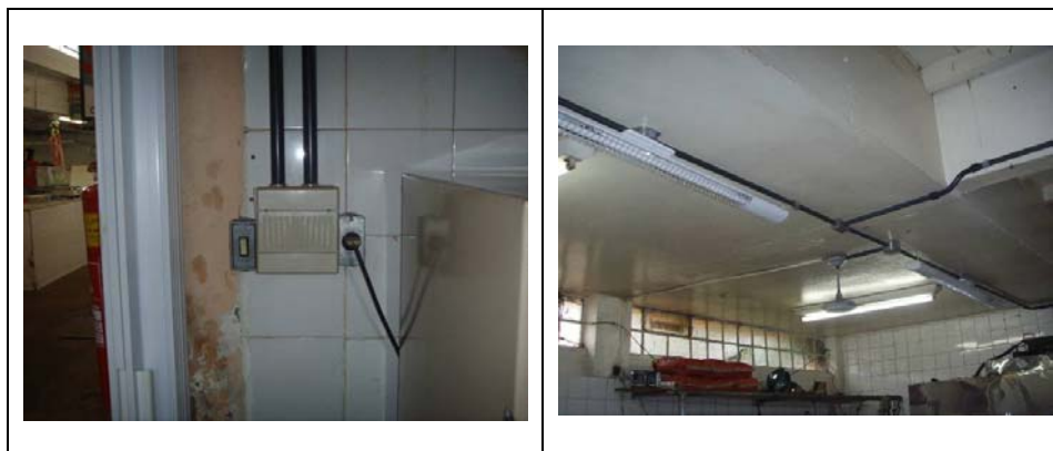
Figuras 10 e 11 - Quadros de distribuição interna e sistemas de iluminação novos
