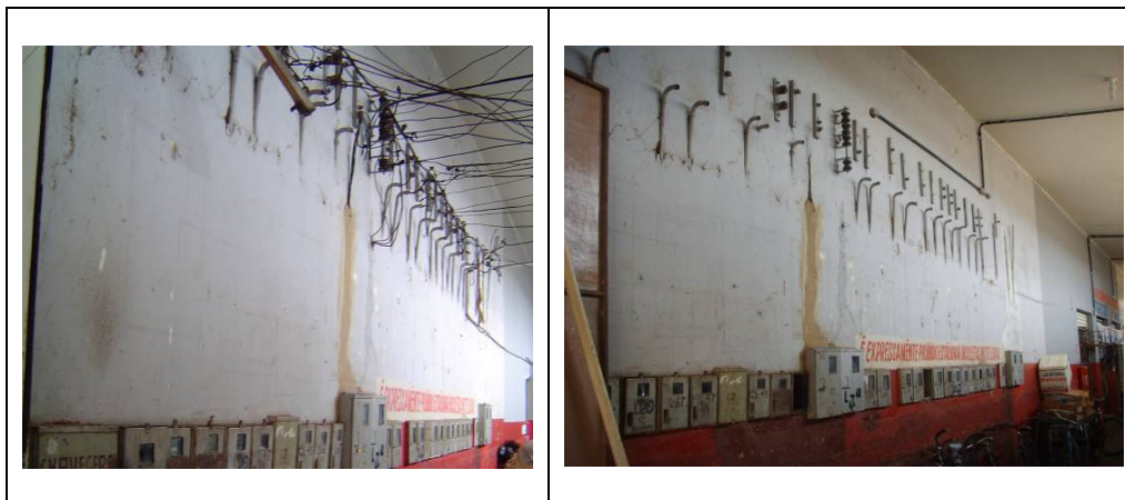
Figuras 6 e 7 - Quadros de distribuição e medição antigos
