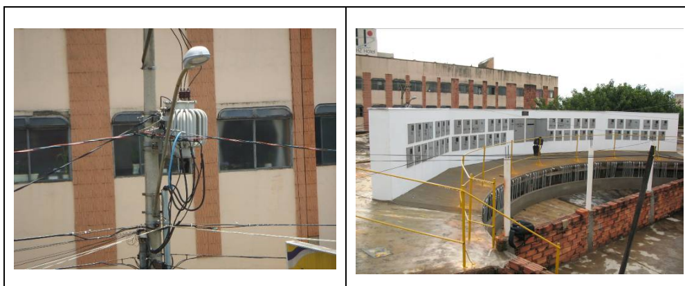
Figuras 8 e 9 - Quadros de distribuição e medição antigos
