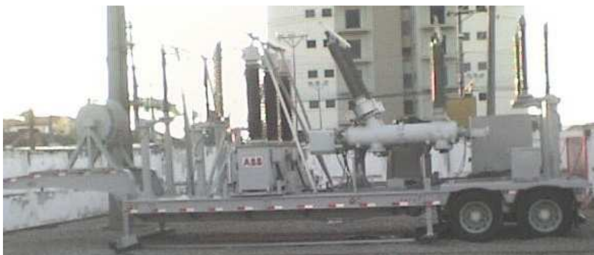
Figura 2 – Unidade Móvel de Alta Tensão
