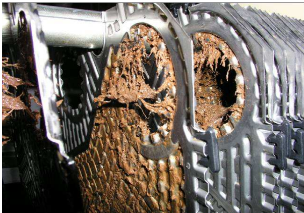
Figura 7 – Trocador de calor sem tratamento aberto após 87 dias de experimento.
