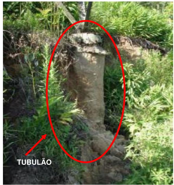
Figura 13 – Suporte com tubulão sem sustentação.
