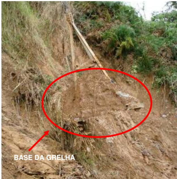
Figura 12 – Torre com uma fundação sem base de apoio.
