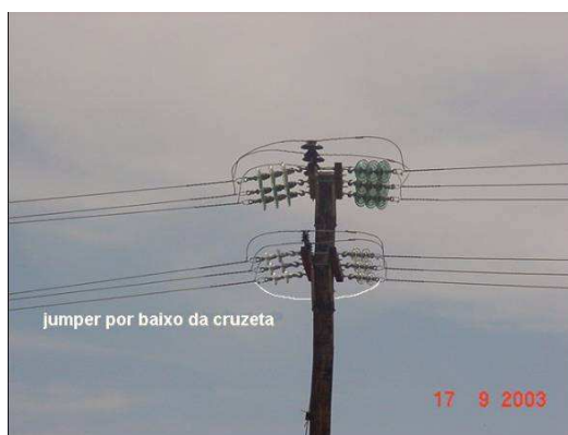
Figura 17 – Jumpers das estruturas de encabeçamento
