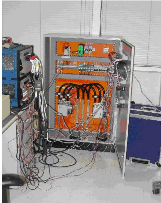
Figura 5 - Painel de Proteção com relés testados em Laboratório e Campo
