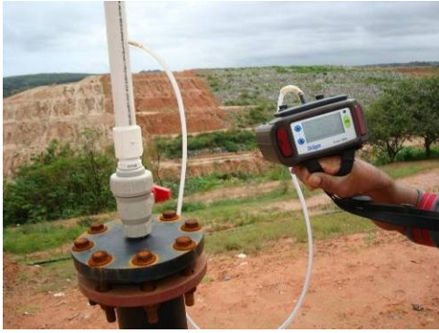
Figura 7. Medição da concentração do biogás no dreno.
