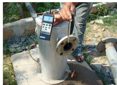
Figura 6. Medição da velocidade na tubulação de coleta do biogás.
