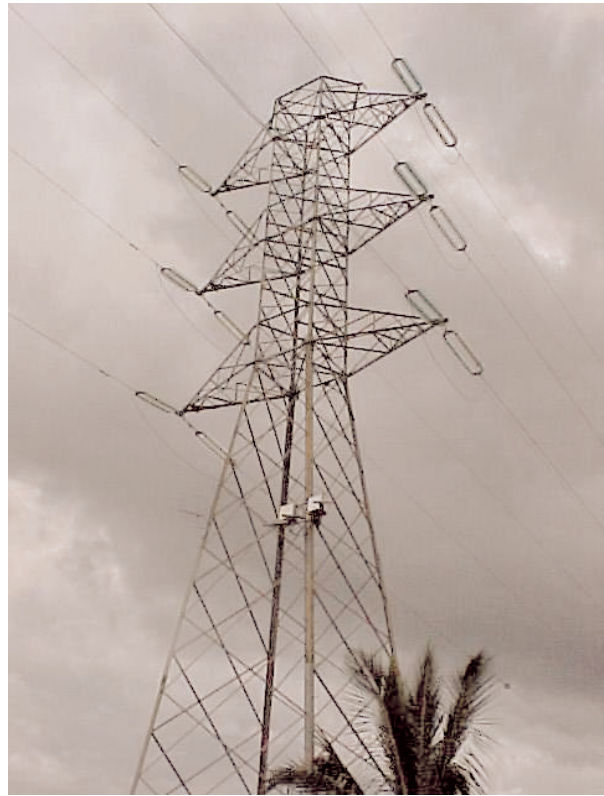
FIGURA 3 – Recapitação da LT Neves 1 – Neves 2, 138 kV
