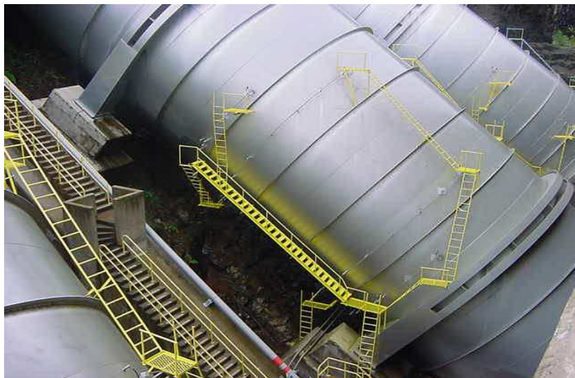
FIGURA 3 - Escadas e plataformas para acesso a instrumentação do conduto.
