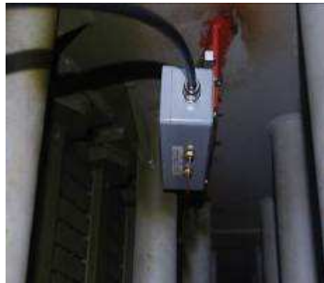
FIGURA 10 Sensor óptico instalado no gerador.
