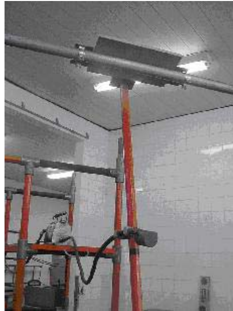
(a) – Detalhe das estruturas isolantes utilizadas e manivela de acionamento da abertura do cofre b) – Detalhe do bico emissor de Raio-X
