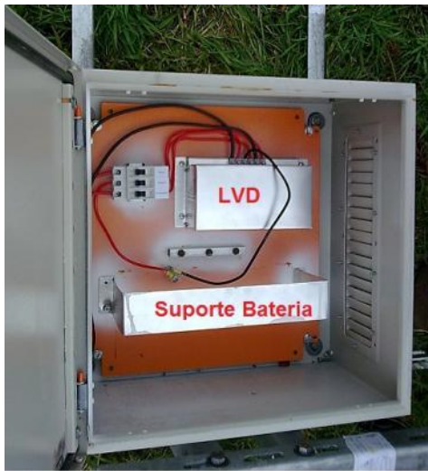
Figura 7. Visão interna do armário do sistema de alimentação
