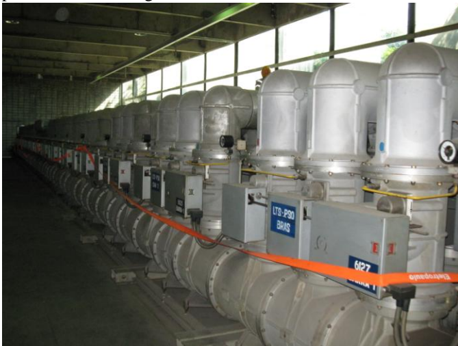
Fig. 1. Subestação GIS de 88 kV da AES Eletropaulo
