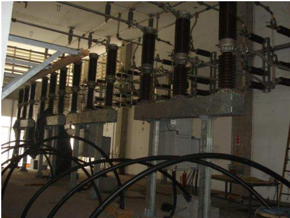
Figura 5 – instalação dos equipamentos convencionais
