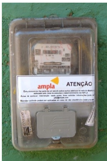
Figura 10 – Advertência aplicada sobre a caixa de medição
