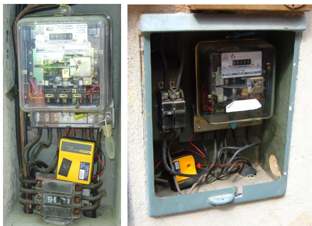
Figura 9 - Registradores de eventos no interior das caixas de medição
