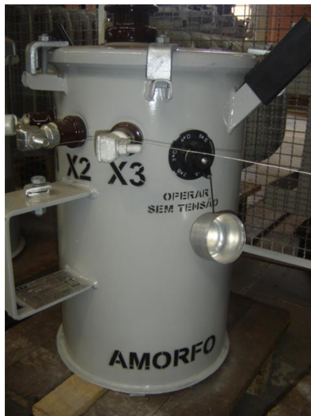
Figura 3. Transformador com buchas de BT em curto-circuito.
