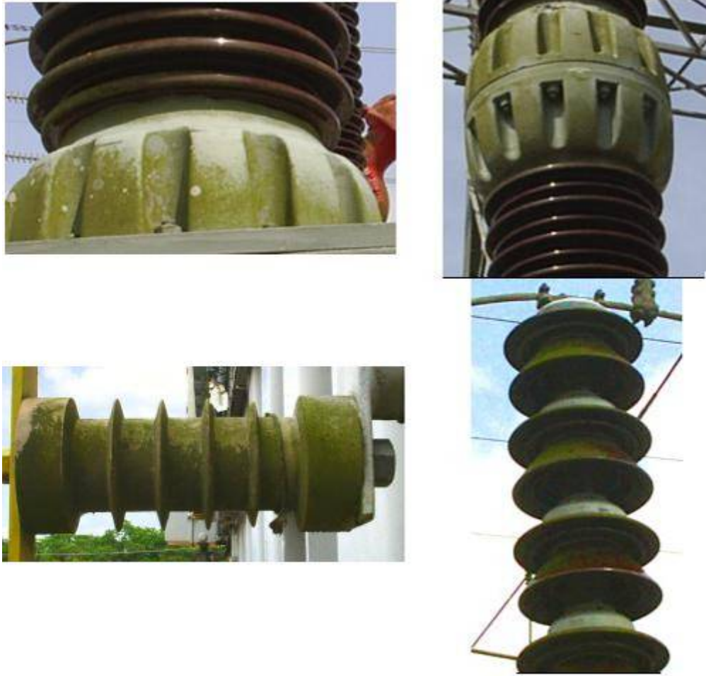
Figura 3 – Equipamentos contaminados com limo na subestação de Rurópolis.
