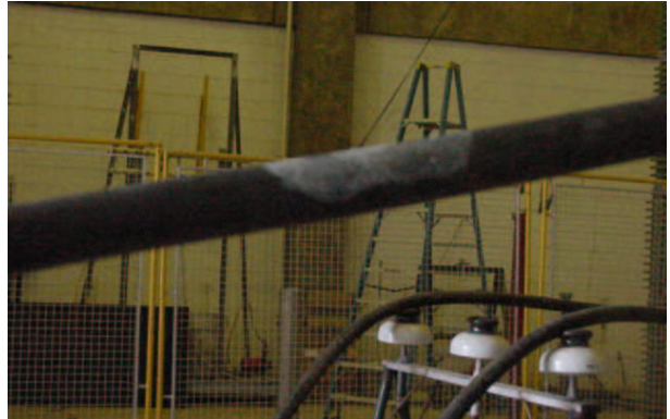
Figura 12 – Danos na cobertura do cabo 5 após ensaio de compatibilidade dielétrica
