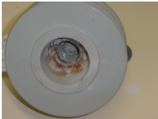
Figura 28 – Exemplo de dano observado nos isoladores pino 2 a 5 após ensaio de compatibilidade dielétrica com cabo 4
