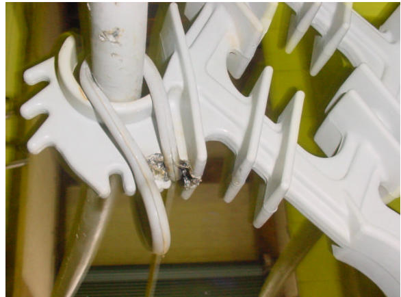
Figura 19 – Danos no espaçador 2 após ensaio de compatibilidade dielétrica com cabo 4
