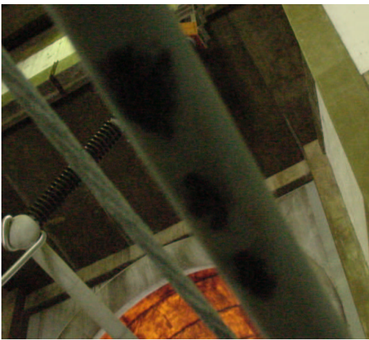
Figura 10 – Danos na cobertura do cabo 3 após ensaio de compatibilidade dielétrica
