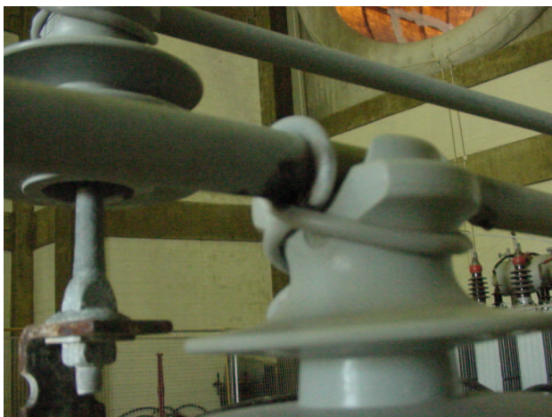
Figura 26 – Dano na interface isolador-cabo em amostra do isolador pino 2 após ensaio de compatibilidade dielétrica com cabo 3
