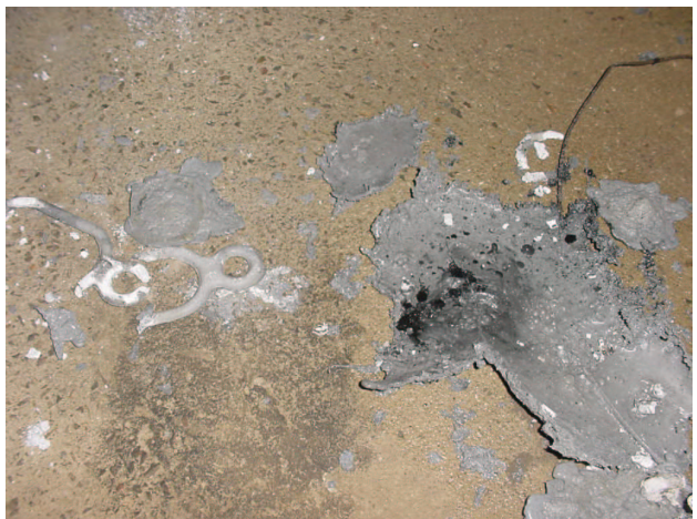
Figura 13 – Espaçador 1 derretido durante ensaio de compatibilidade dielétrica com cabo 1
