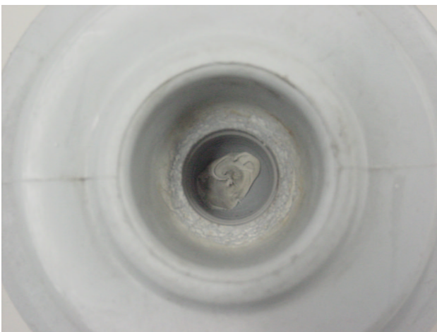
Figura 7 – Danos no isolador pino 3 após 8 meses no campo
