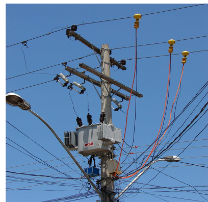
(b) Instalação dos medidores (MT e BT)
