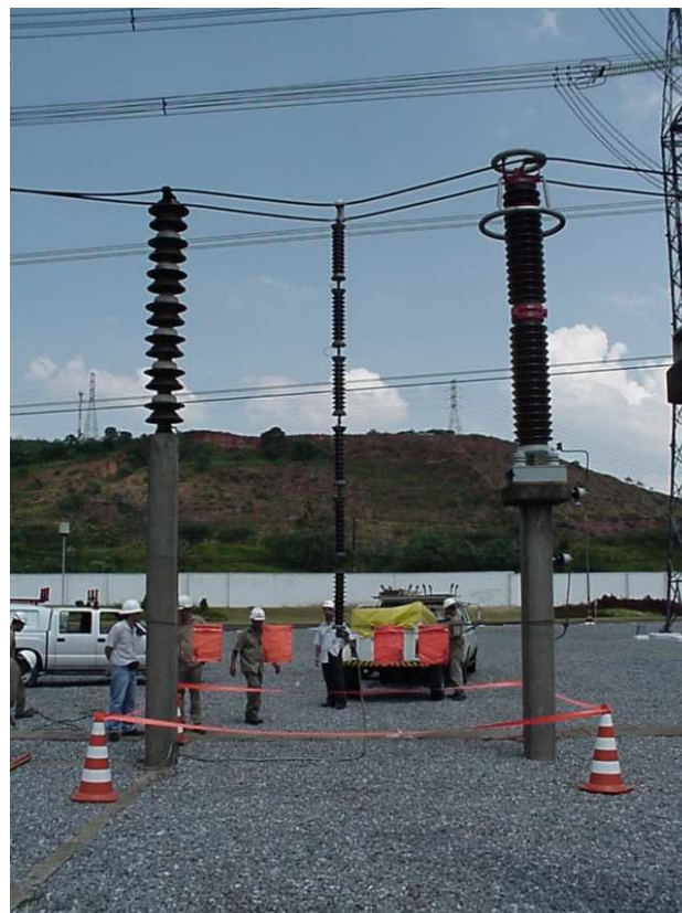
Figura 5– Módulo Primário do Divisor Capacitivo (na LTS Xavantes Bandeirantes 1 – fase branca). Exemplo de montagem.
