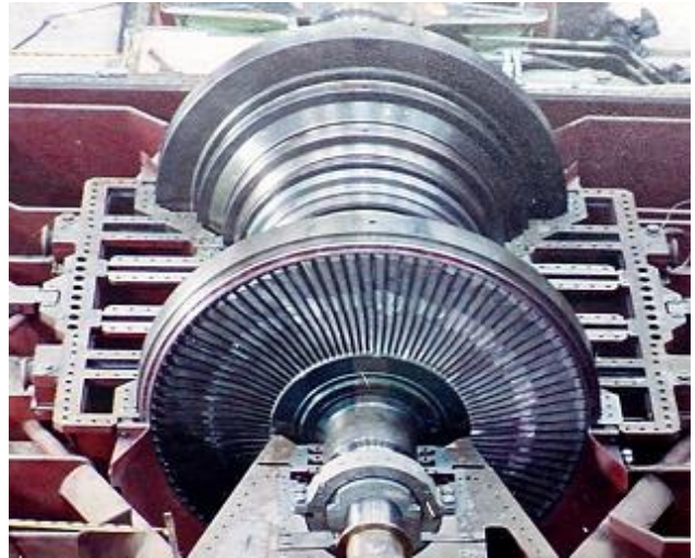
Figura 1. Vista geral da turbina a vapor.
