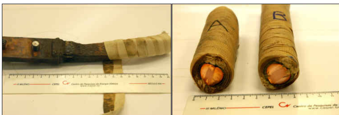
Figura 1 – Terminal da bobina de AT isolado em tecido e condutores cilíndricos de cobre (A) e (B), isolados em papel, da bobina de regulação do transformador
