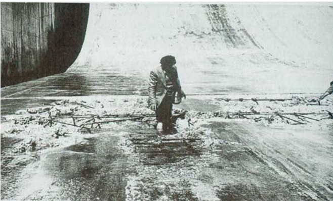
Figura 5. Danos provocados por cavitação na barragem de Keban [02].
