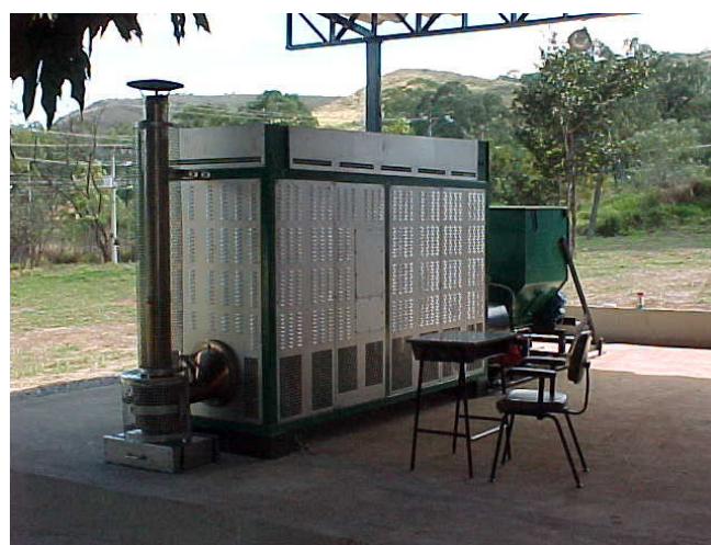
Figura 6 – Microturbina a Líquido Orgânico instalada na EFAP, em Sete Lagoas/MG.
