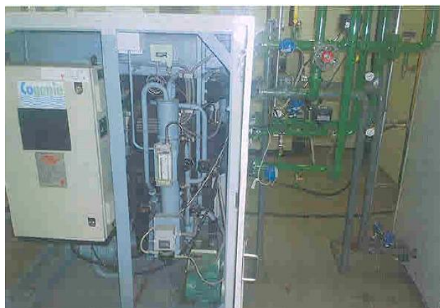
Figura 7 – Chiller da Absorção, Laboratório NEST/UNIFEI.
