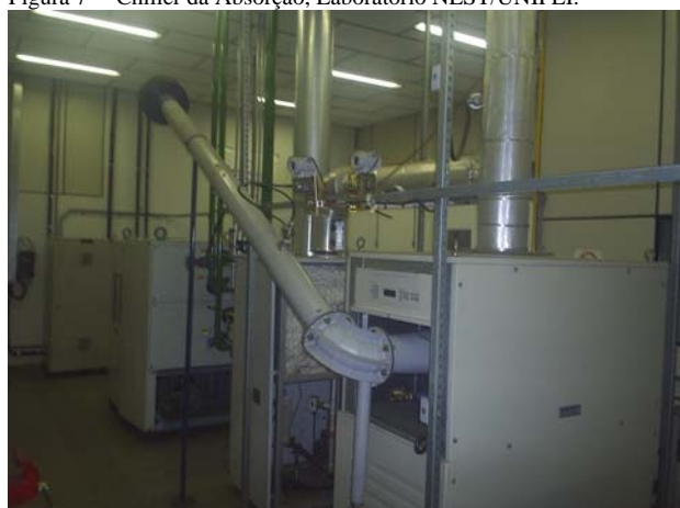
Figura 8 – Chiller da Absorção acoplado a Microturbina a gás, Laboratório NEST/UNIFEI.
