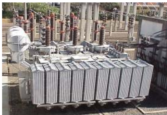
FIGURA 2 – Transformador de potência
